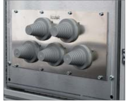
Rittal TS8 panosuna modül plakası ile bölmelerden kablo girişleri sağlanmış.
