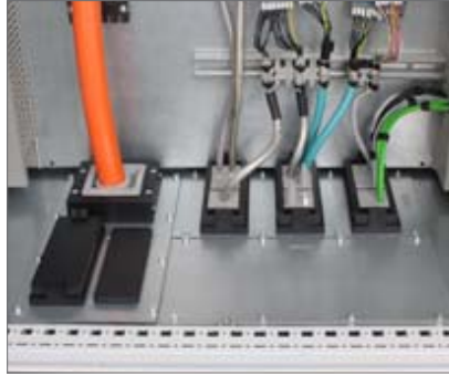
Rittal TS8 panosuna modül plakası ile kablo girişleri. Montaj icotek KDR-BMP taban sacı ile gerçekleştirilmiştir.
