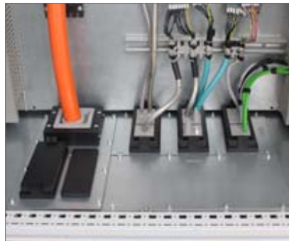
Kaapeleiden läpivienti moduulilaipan avulla TS8 kaapissa. KDR-BMP
