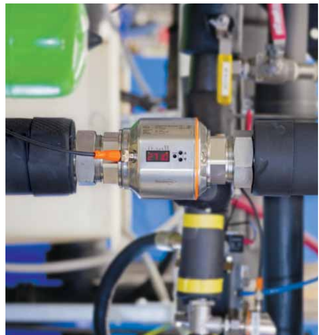
Caudalímetro magneto-inductivo para la medición de la cantidad de agua en un sistema de filtración.
