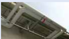
改修後の配管 (写真は熱応力を緩和する ためのエルボが写っている)
